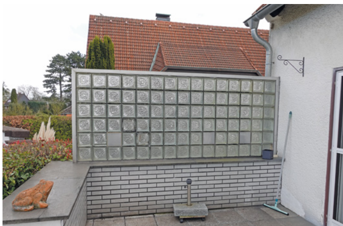
Sichtschutzwand mit Glasbausteinen – Zwangsspannungen haben Glasbruch verursacht
