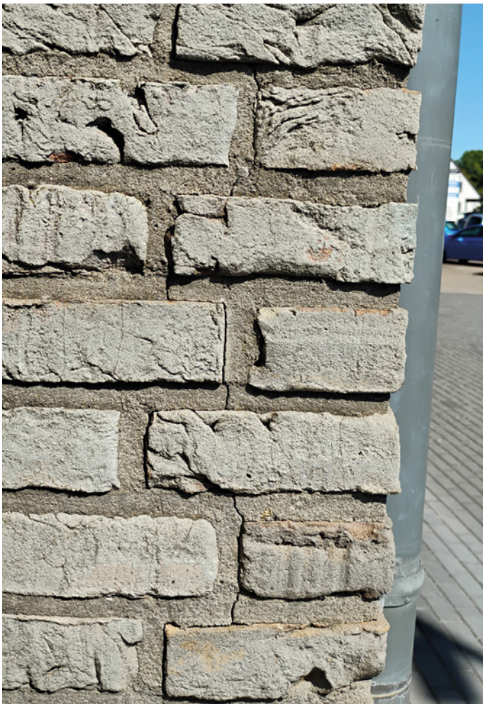
Klinkerfassade ohne Eckfuge mit Rissen
